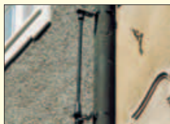
Mobilfunkantenne als Mikrozelle an Dachrinne
