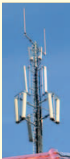
Mobilfunkantennenanlage auf Hausdach
